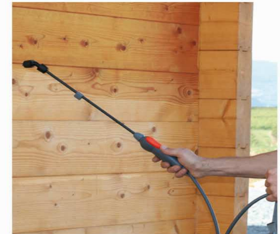
Pour le traitement des bois
